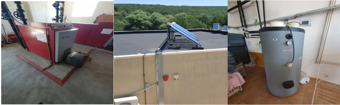
Котел на нафта и соларна система за топла вода и битови нужди
