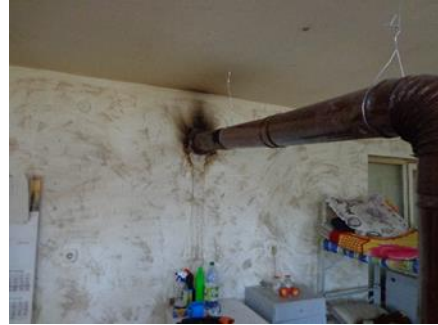
Следи от опушване по стените
