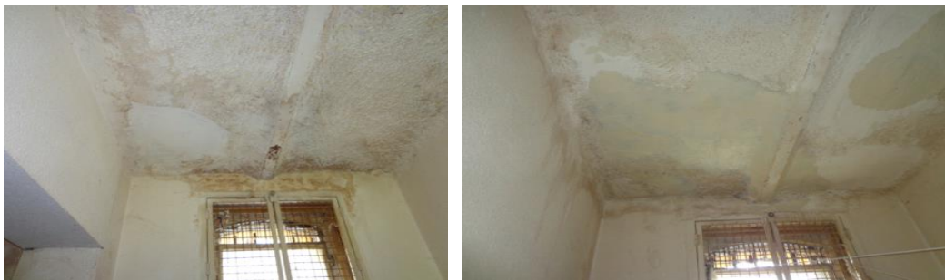
Помещения в ареста, засегнати от постоянни течове от етаж на първа затворническа група на Затвор – София
