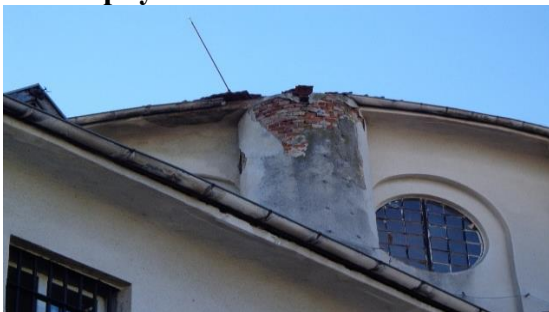
Изглед отвън на рушащата се мазилка
