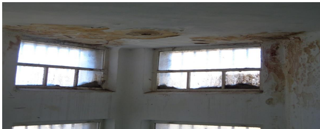
Следи от теча на покрива
