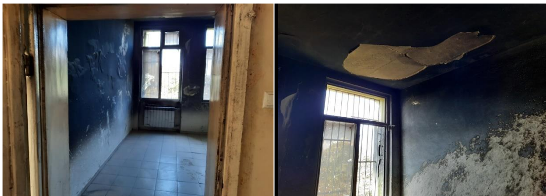
Обгорелите стени в изолятора
